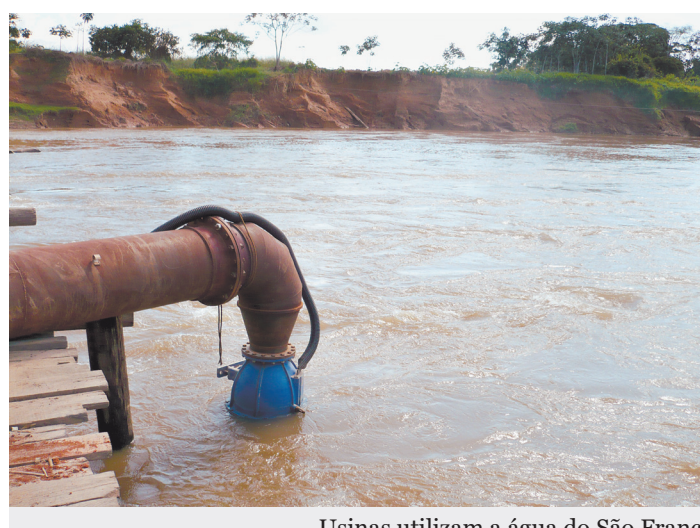
Usinas utilizam a água do São Francisco para irrigação e lavagem da cana e resfriamento de caldeiras
